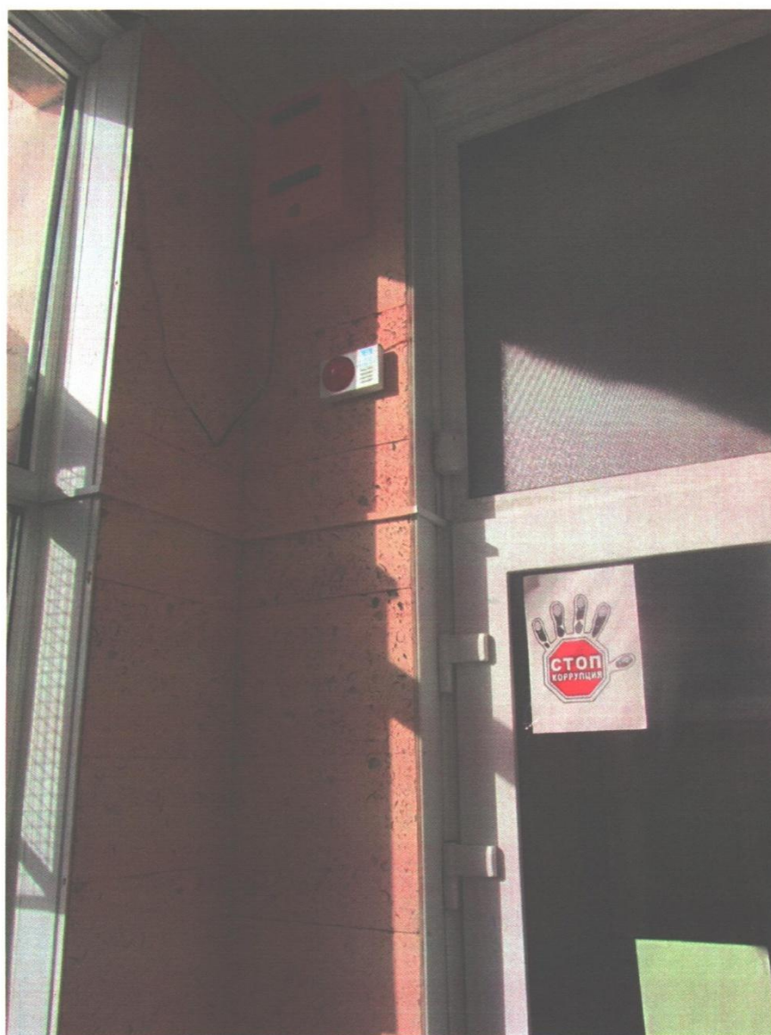
Приложение 11 Акустическая пожарная система мониторинг
